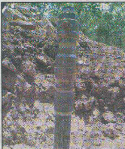
EN el sitio de la toma clandestina había un montón de desperdicio de material de construcción con el que los delincuentes pretendieron tapar el pozo de entre 30 y 40 centímetros de profundidad, donde rompieron el ducto del combustible para conectar una válvula que les permitiera unir a una manguera de 2 pulgadas aproximadamente.
