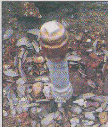
EN el mismo sitio donde se detectó la primera toma clandestina de hidrocarburos en Yucatán, en octubre del 2017, hay otra toma que ayer lucía acordonada con cinta de hace días cubierta de palos de madera y la tierra se veía húmeda, como si la "ordeña" se hubiera registrado recientemente.
