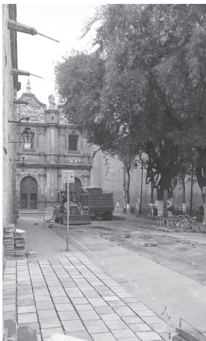
Figura 7. Obras para la peatonalización de calles en el C. H. de Morelia. Fotografía de Carlos Hiriart. Marzo de 2017.
